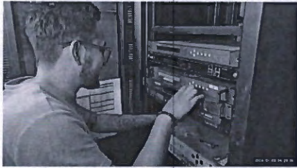
Ajuste de frecuencia del sistema de recepción
