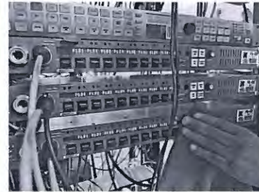
Remoción de polvo al sistema de intercomunicación de las cabinas
