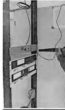
Limpeza de los equipos del rack de transmisión
