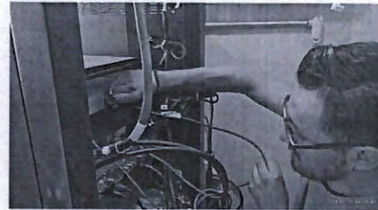
Remplazo de cable SDI al receptor satelital
