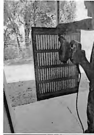
Limpeza de los equipos del rack de transmisión
